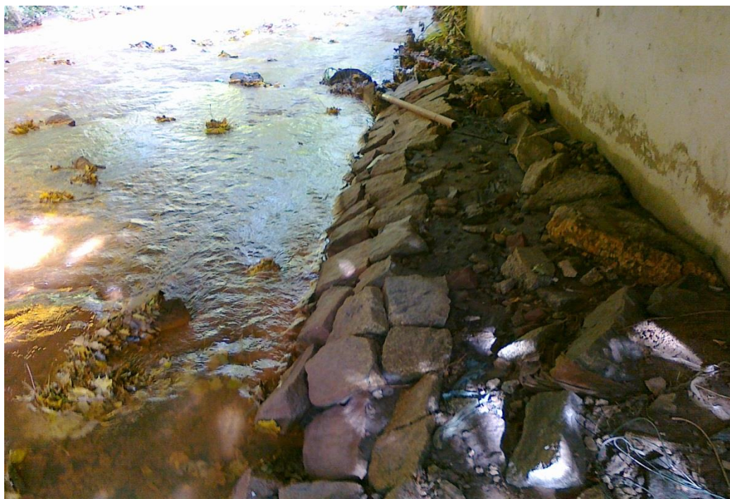
Zdj. nr 12. Widok przyczółka prawobrzeżnego od strony górnej wody, stan ogólny okładziny kamiennej umocnienia przyczółka w strefie posadowienia na fundamencie – zły. W konstrukcji umocnienia występują ubytki kamienia i rozluźnienie elementów kamiennych na wysokości przepływającej wody.
