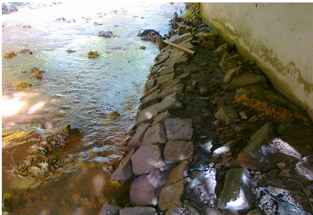
Zdj. nr 12. Widok przyczółka prawobrzeżnego od strony górnej wody, stan ogólny okładziny kamiennej umocnienia przyczółka w strefie posadowienia na fundamencie – zły. W konstrukcji umocnienia występują ubytki kamienia i rozluźnienie elementów kamiennych na wysokości przepływającej wody.
