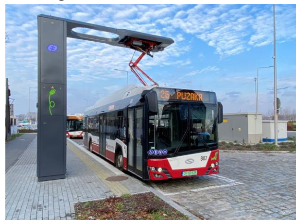
Rys. 1.1 Autobus elektryczny akumulatorowy MAXI w Opolu w trakcie szybkiego ładowania ze stacji ładowania pantografowego
